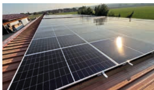
2025_ Solaranlage Tschechien mit 400 kwp
