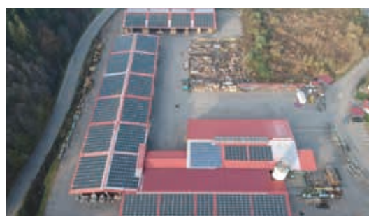
2019_ Solaranlage Amtzell mit 749 kwp
